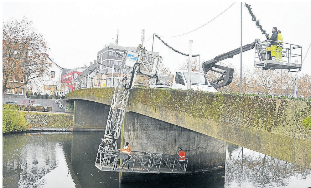
Während oben die Weihnachtsbeleuchtung angebracht wurde, untersuchten unten Mitarbeiter eines Ingenieurbüros die Nepomukbrücke auf Schäden.
